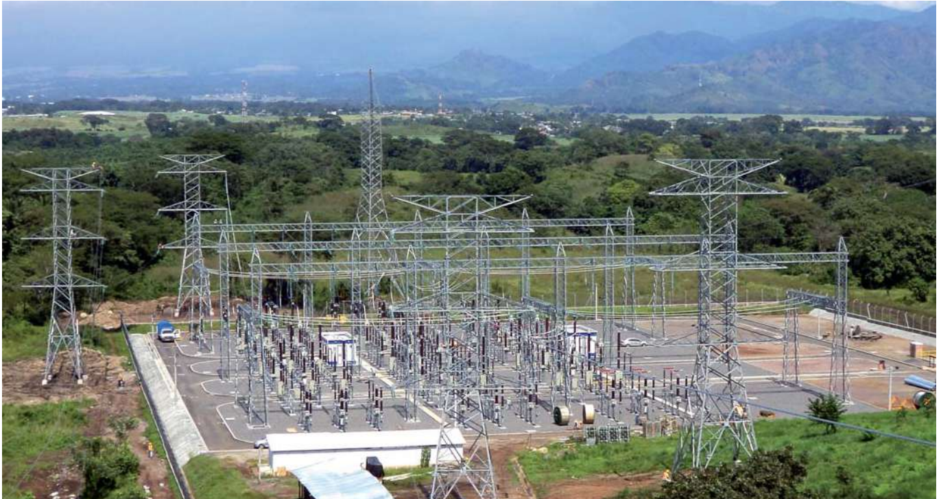
SUBESTACIÓN SOCABAYA Y LÍNEAS DE TRANSMISIÓN 220 kV Y 138 kV A CERRO VERDE Y CHARCANI V. DISEÑO Y SUPERVISIÓN DE OBRA.
