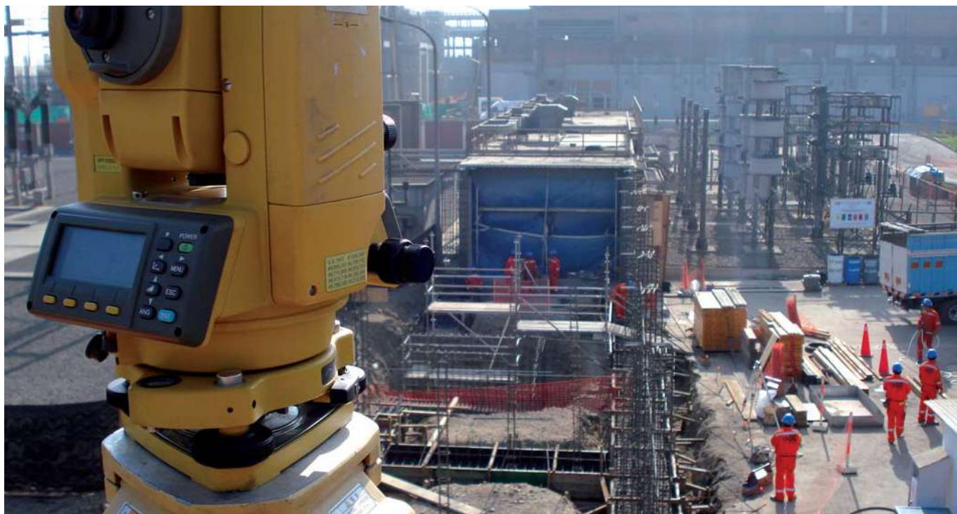
PROYECTO DE EXPANSIÓN 320 k. REFINERÍA DE ZINC DE CAJAMARQUILLA. CONTROL DE OBRAS.
