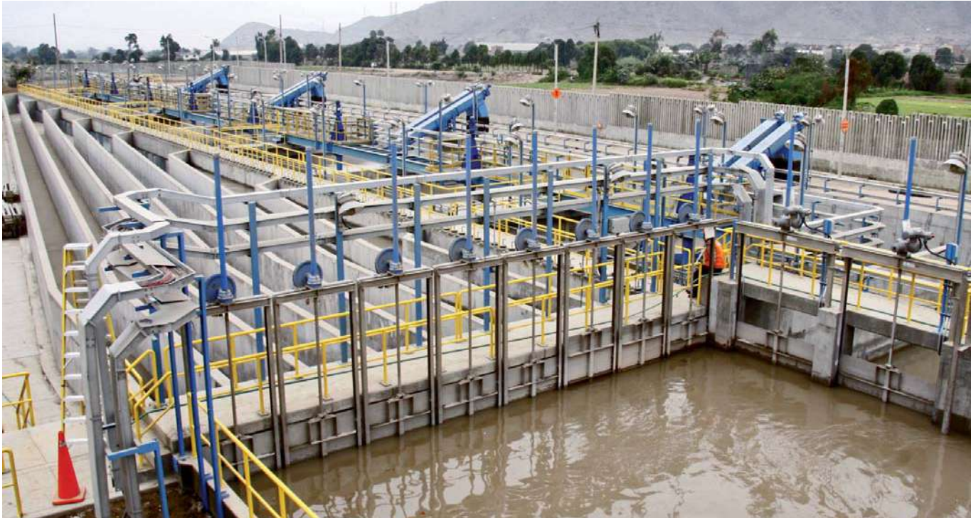
PLANTA DE TRATAMIENTO DE AGUA DE HUACHIPA.
