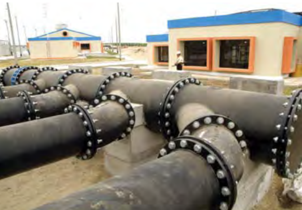
Tuberías de impulsión a la planta de tratamiento de agua potable de Curumuy. Piura.
