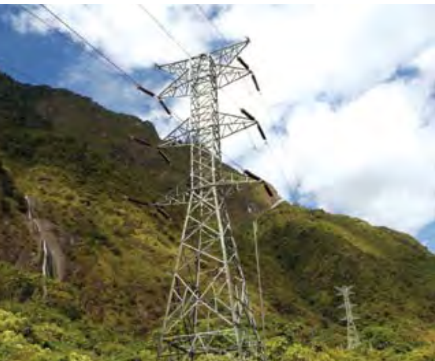
L.T. San Gabán - Azángaro 138 kV. San Gabán - Azángaro 138 kV transmission line.
