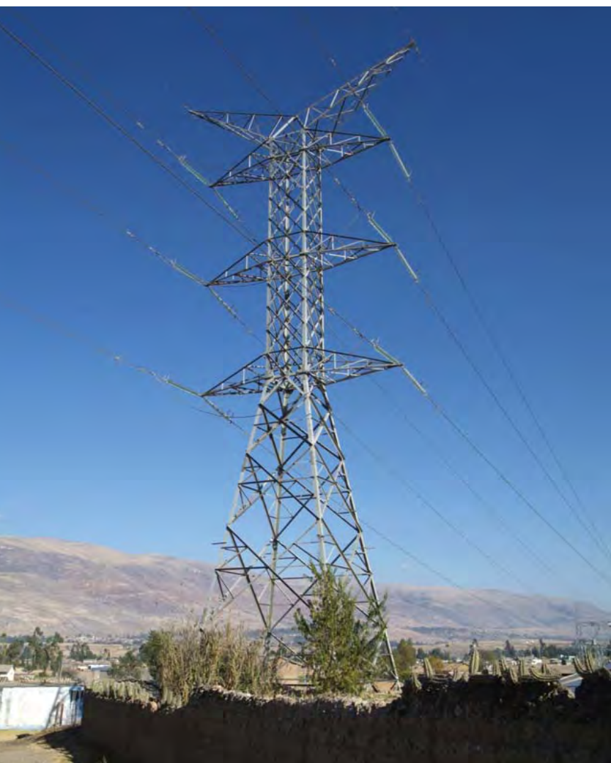
L. T. Mantaro - Pachachaca - Callahuanca 220 kV. Mantaro - Pachachaca - Callahuanca 220 kV transmission line.
