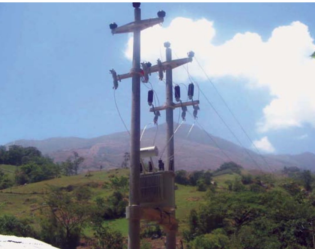
PSE Santo Domingo de Chalaco I y II Etapa. PSE Santo Domingo de Chalaco I y II Etapa.
