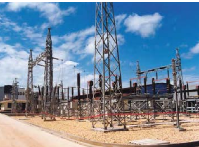
Subestación San Gabán, 138 kV. San Gaban substation 138 kV.
