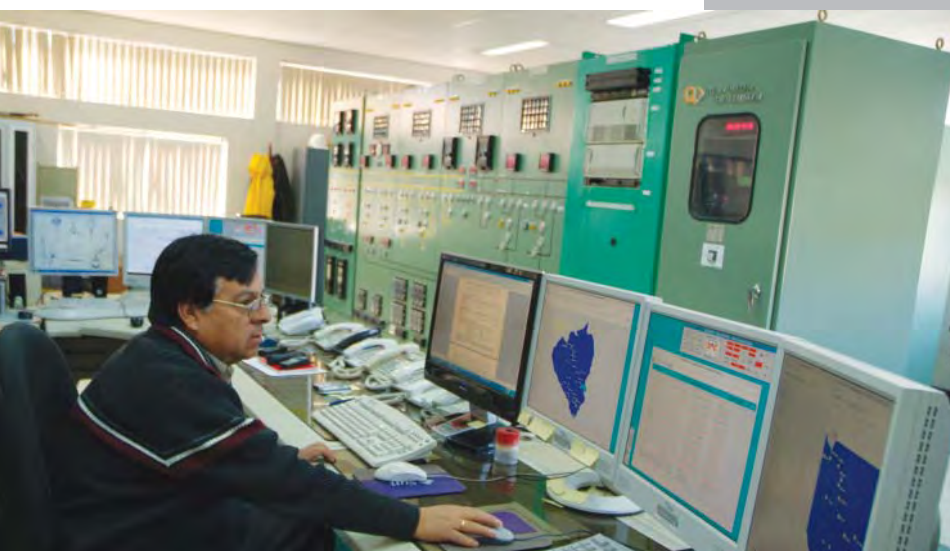
Centro de Control de ETESUR. Control center ETESUR.
