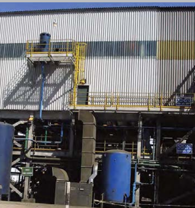
Planta de Filtrado de Cobre SPCC. Copper SPCC filtration plant.
