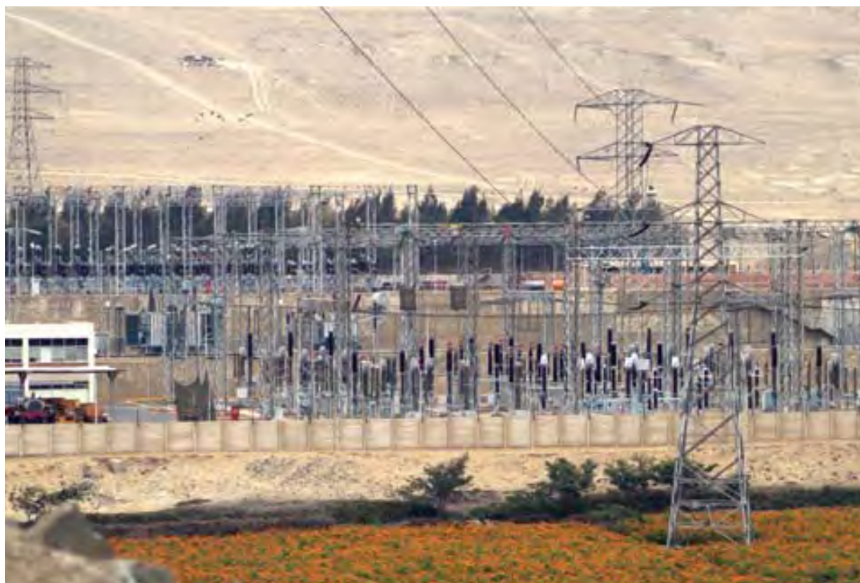
Subestación Paramonga 220 kV. Paramonga 220 kV substation.
