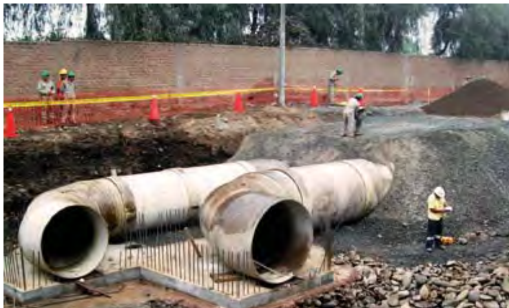
Línea de aducción de agua de 1,6 m y 1,8 m Ø. Water pipe-line 1,60 m and 1,80 m diameter.
