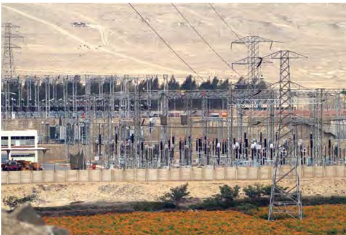
Subestación Paramonga 220 kV. Paramonga 220 kV substation.
