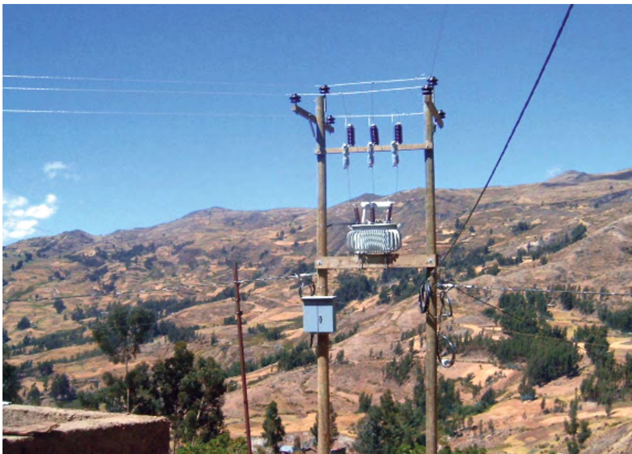
Subestacion Trifasica de Pasacancha. PSE Sihuas – Quiches II Etapa. Subestacion Trifasica de Pasacancha. PSE Sihuas – Quiches II Etapa.
